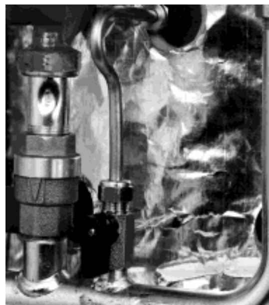
Фото А: Кран заполнения
