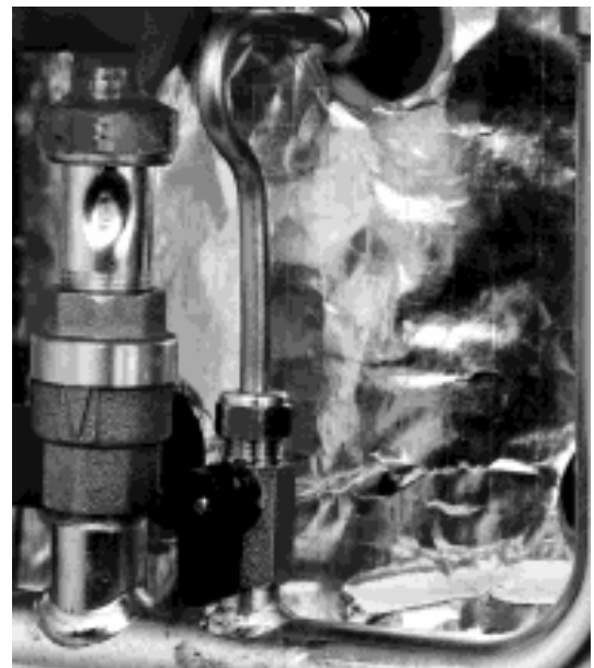
Фото А: Кран заполнения
